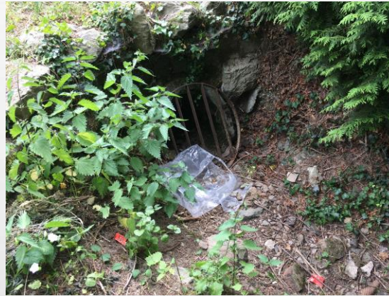
Einläufe in Verrohrungen
