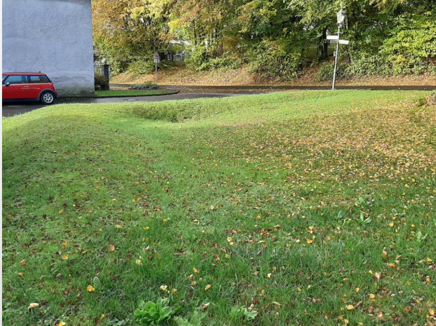
Abbildung 29: Einlauf des Quellgebietes in die Verrohrung, Freirachdorf (Quelle: GBi Kommunale Infrastruktur GmbH)
